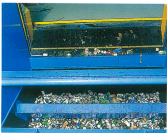
供給バケットの内部
