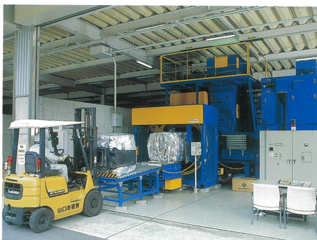
制御盤・圧縮機・梱包機・ペール出口
