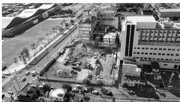
済生会山口総合病院 解体工事中の病棟(南棟建設予定地)
