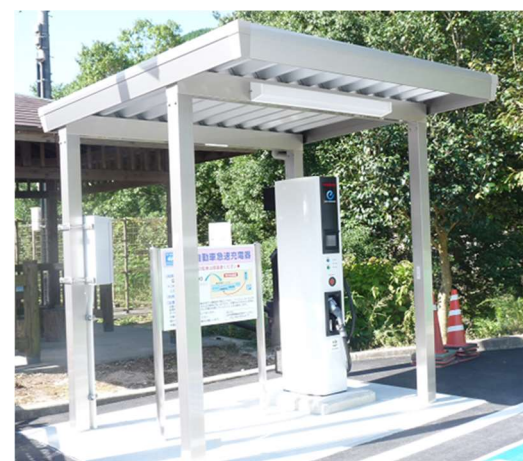
道の駅長門峡 急速充電器
