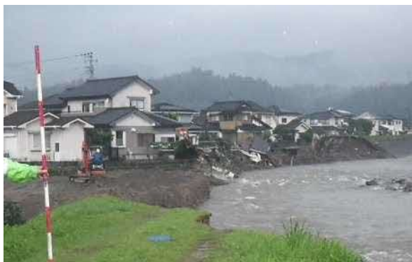
河岸侵食による家屋の倒壊(花月川)
