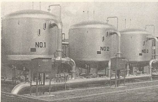
第三水源地に完成したマンガン除去装置
