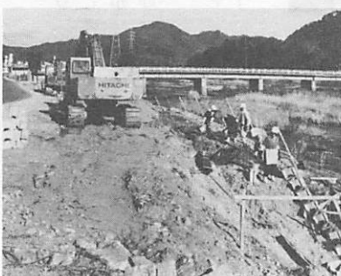
豊年橋下流の工事。堤防の高水位部を利用して道がつけられています。
