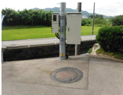
マンホールポンプ外観
