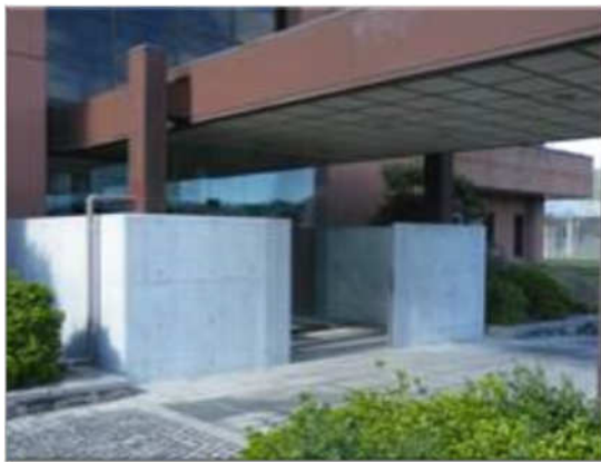
防水壁(通常時)
