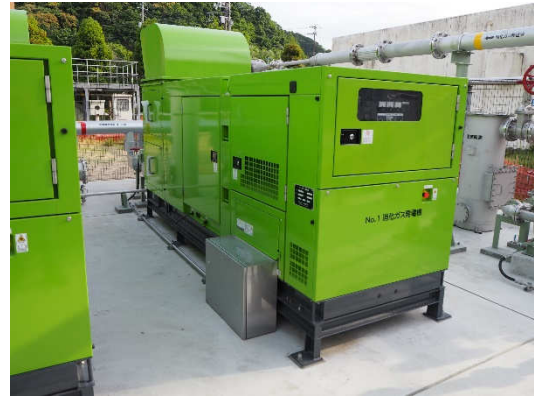
消化ガス発電機
