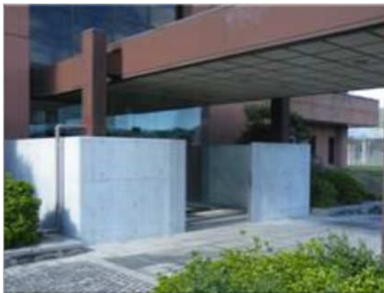
防水壁(通常時)
