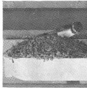
役場庁舎内の通路に、最近取り付けられたけい光灯のかさへ、早くもツバメが巣づくりを始めました。
