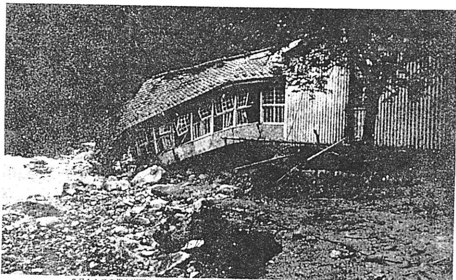
7月11日の集中豪雨で全壊した柚野小学校の北側校舎 (7/12写す)
