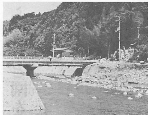
防災への備えと環境美化のもとに進められる護岸工事 (古熊東山橋付近)
