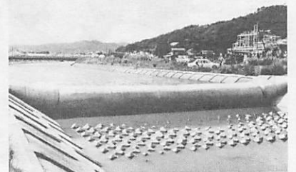
ゴム引布製起伏堰。今津川と土路石川に設置されました(写真は今津川)
