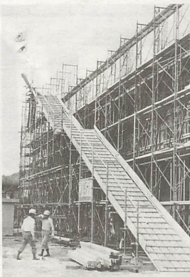
来年3月末を目途に建設が進む鴻南中学校校舎の建設工事
