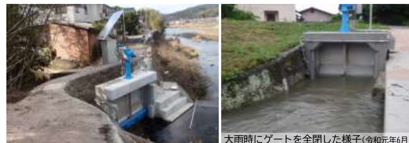
大雨時にゲートを全閉した様子(令和元年6月) 取水ゲートの自動化整備(仁保川 楠井出(大内))
