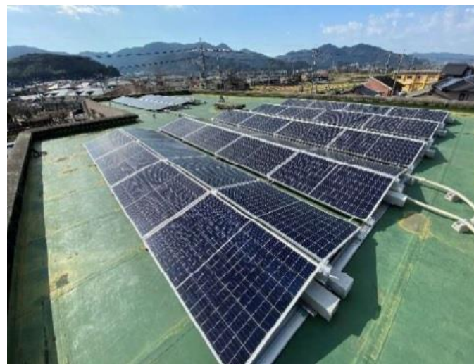
再生可能エネルギーの活用 （平川地域交流センター屋上）
