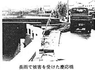
長雨で被害を受けた慶応橋
