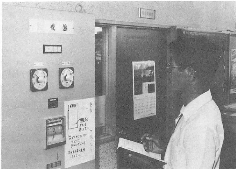
丸塚山配水池の水位などは役場倉庫内で監視できる
