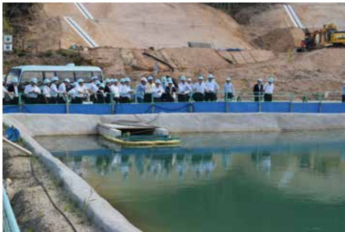
土木造成工事用の濁水処理設備
