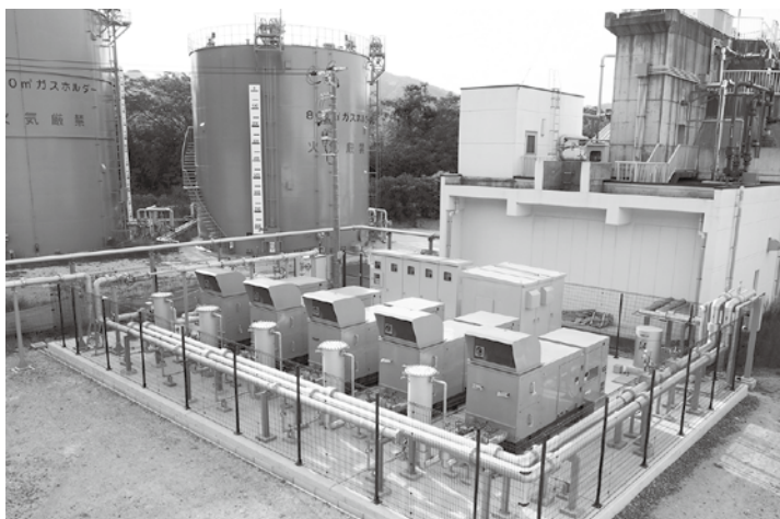
山口浄化センターに設置された消化ガス発電施設
