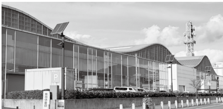
被害を受けた屋根の一部がブルーシートで覆われている（写真右側）
