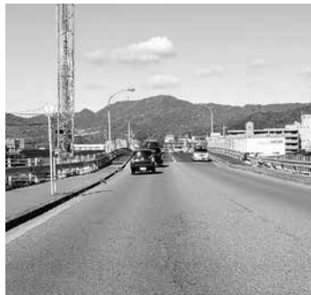
長期間、中央線が消えている市内の道路
