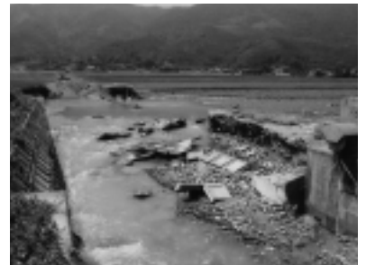
災害被害を受けたほ場（小鯖地区）
