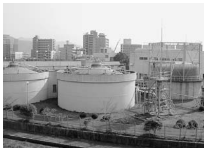
小郡浄化センターの汚泥消化タンク設備ほか
