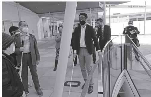
手すりを伝って歩くと支柱に衝突する箇所（2階）
