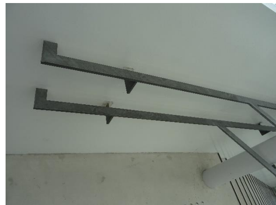
点字による案内が未設置の手すり
