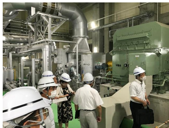
蒸気タービン発電機
