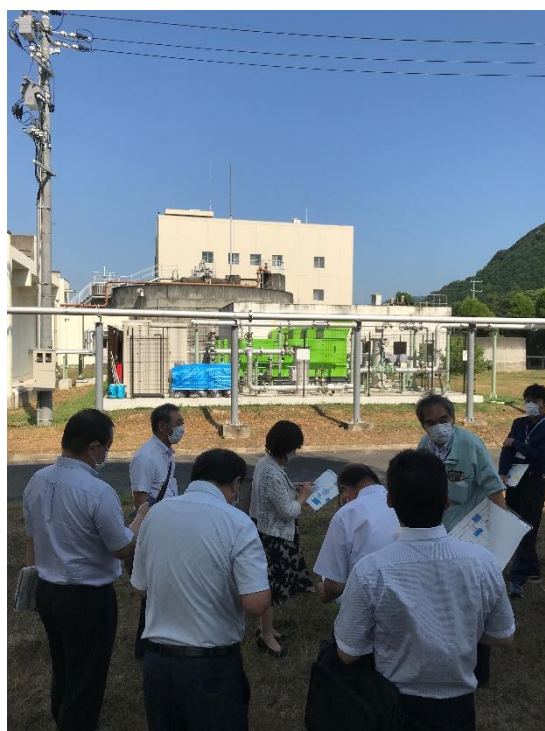
民設の消化ガス発電機
