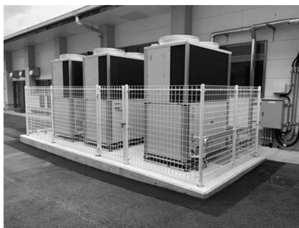
エアコン室外機
