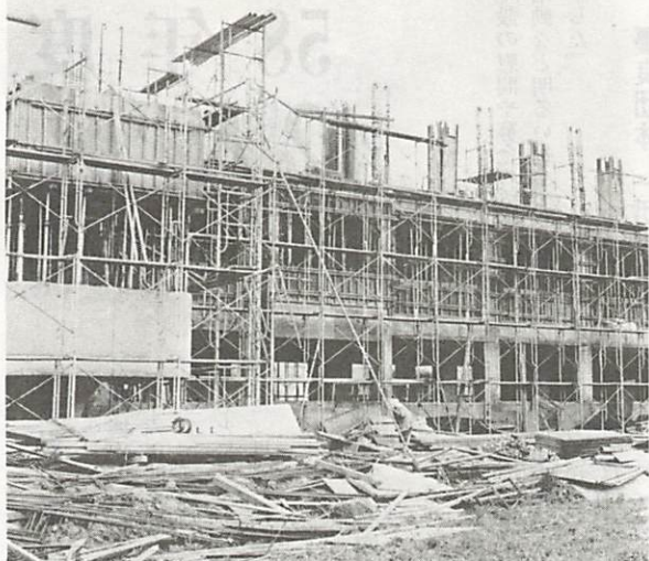
プレハブ校舎の解消をめざし、建設が進む大内中学校の校舎増改築工事。新校舎は鉄筋コンクリート造3階建て、普通教室を9教室、特別教室を3教室新設します
