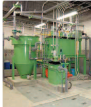
■排水処理設備
