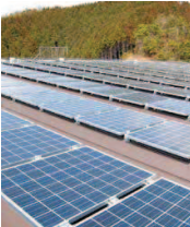
■太陽光発電設備
