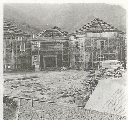
10月の開館をめざし、本館工事が進められている山口ふれあい館
