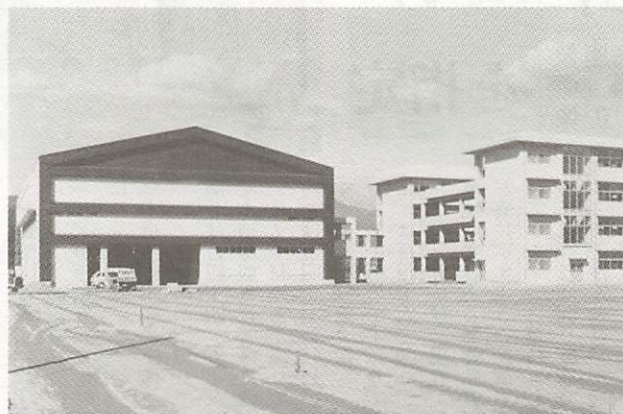
広い敷地に、校舎、屋内運動場、体育施設などの建設が進む県立西京高校
