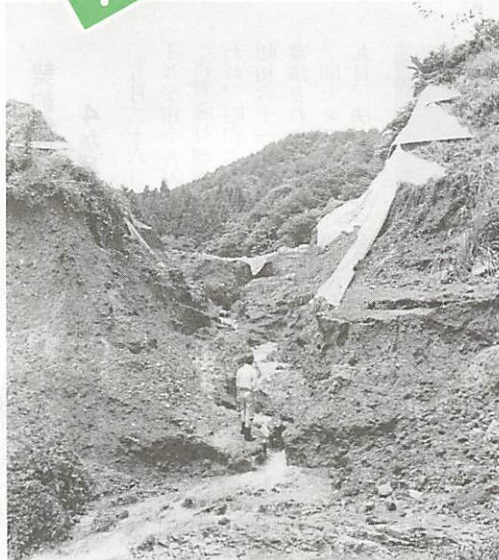
昨年決壊した野口堤の堤体。このときは、3,000トンもの貯水が下流の人家を襲い、2人の尊い人命を一瞬のうちに奪った。
