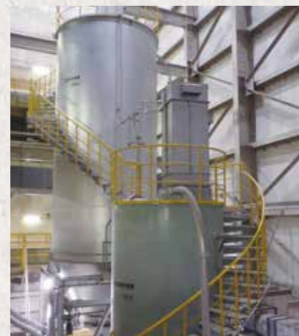
6 消石灰・助剤貯留槽
