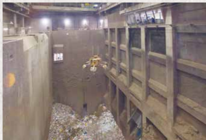
2 ごみピット・ごみクレーン
