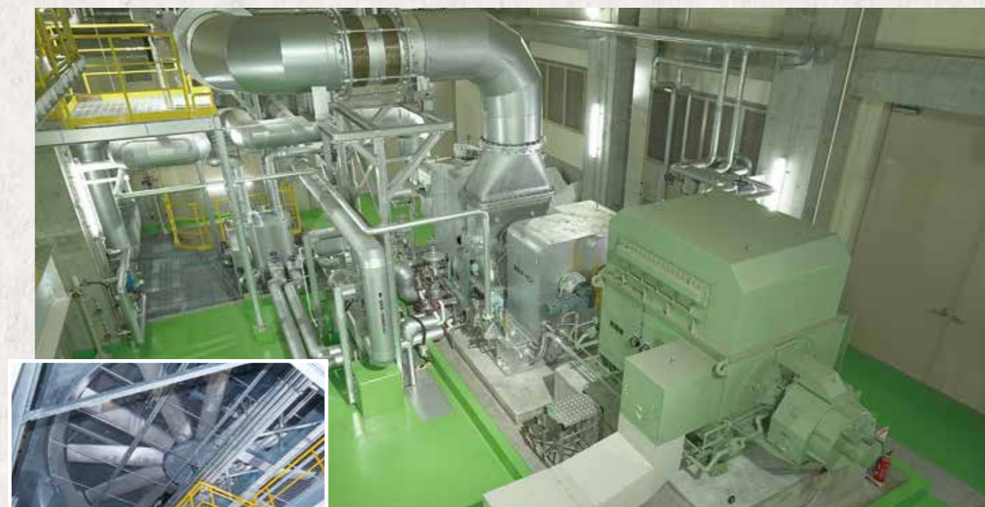
9 蒸気タービン発電機
