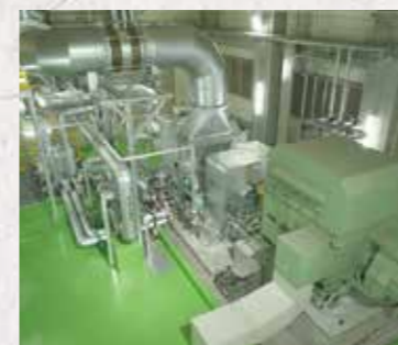
蒸気タービン発電機
