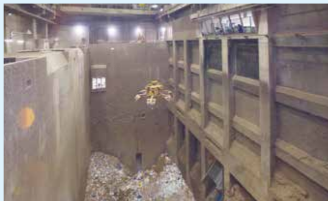
2 ごみピット・ごみクレーン
