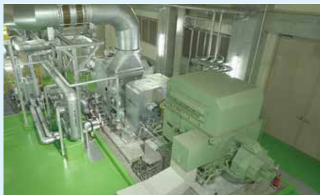
6 蒸気タービン発電機
