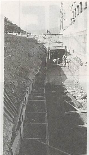
宮島町での都市下水路工事 このほか矢原、平川、大内、御堀、佐山テクノパーク・佐山由良で工事中です。
