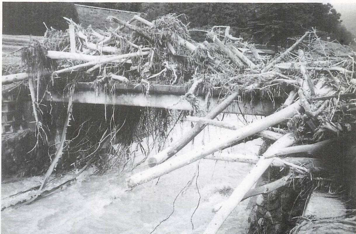
どこが橋やら立木の干物となった 農道宮村線の橋りょう
