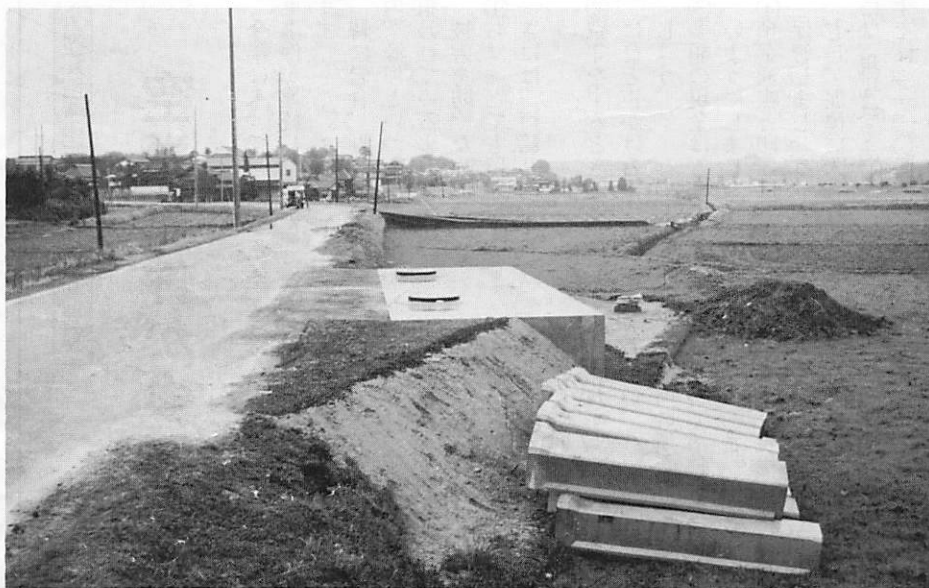
⑥ 井関地区に新設された防火水槽
