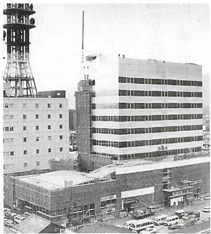
建設…と一口で、山口市の建設現場。急ピッチで進められている。完成後は、高度情報通信網の中核といえる重要な施設となる。急ピッチで進められている。完成後は、高度情報通信網の中核といえる重要な施設となる。
