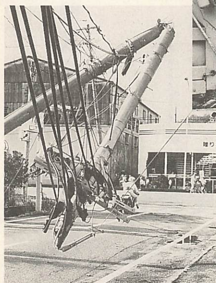
△電柱の倒壊は、何日にもわたり大停電を引き起こし、市民生活に考えられないような打撃を与えました。
