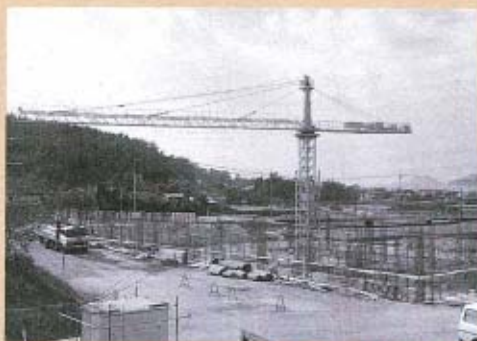
トンボクレーンを駆使して、現在、1階躯体工事を進めています
