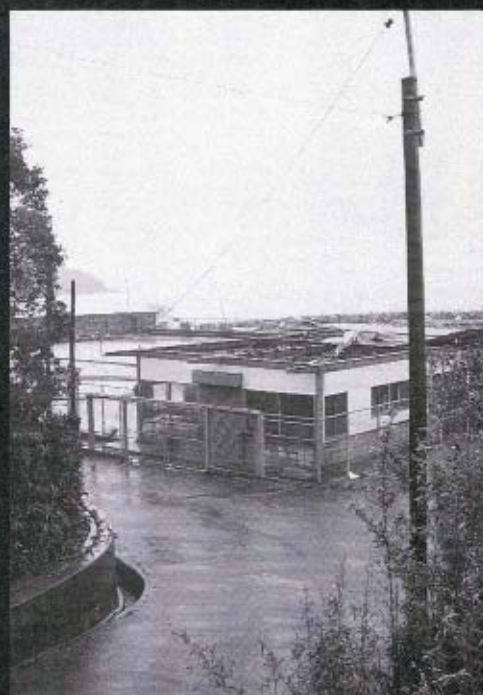
町民プールの屋根も吹き飛んだ
