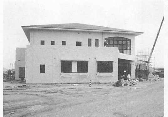
▲本町が宇部市と行う公共下水道・阿知須浄化センターが干拓地南端で着工(2月4日) 完成予定は平成7年
