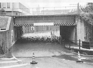
▲水がたまった地下道
