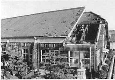
平成3年 台風19号 瞬間風速44mを記録 強風により大きな被害
