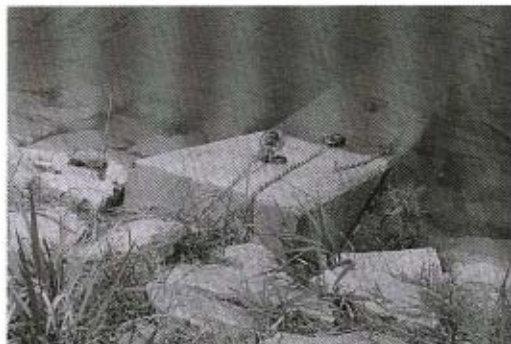
「斜樋」はため池の心臓部
