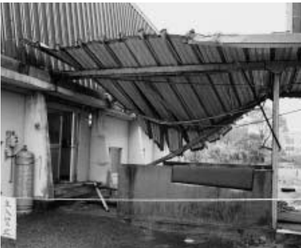
崩れ落ちた中央公民館と講堂をつなぐ渡り廊下の屋根
