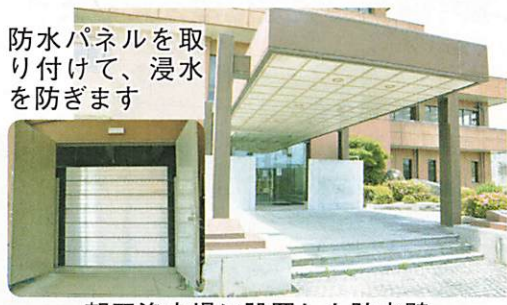
朝田浄水場に設置した防水壁
