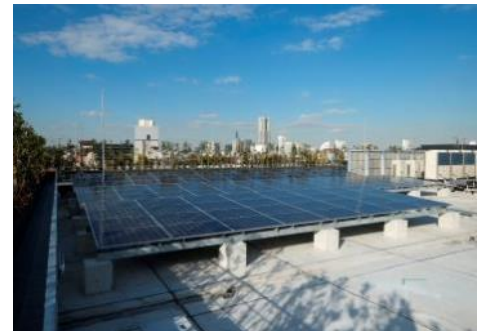
太陽光発電パネル（横浜市南区）
