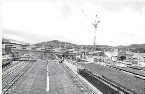
新山口駅ターミナルパーク整備事業では、現在、橋上駅舎の基礎工事を行っています。
