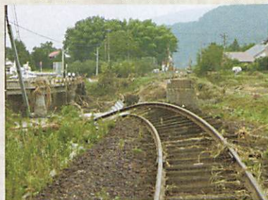
河川の氾濫で曲がった線路
